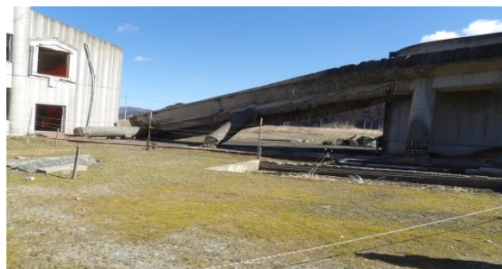
津波で破壊された渡り廊下
