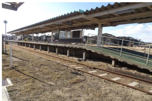
津波で破壊されたホーム
